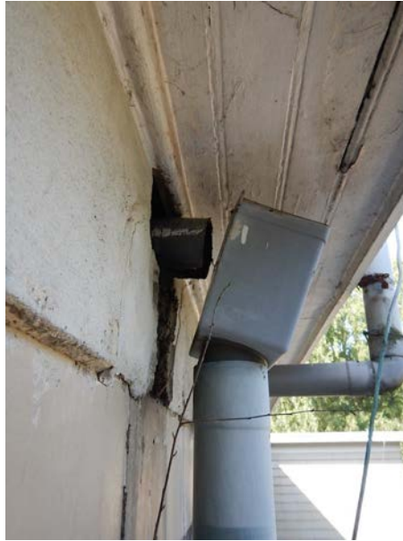
Dak [1]-noord: losgekomen vergaarbak.
