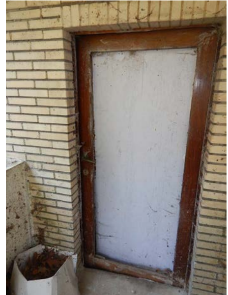
Vleugel [8]: ontbrekende beglazing.
