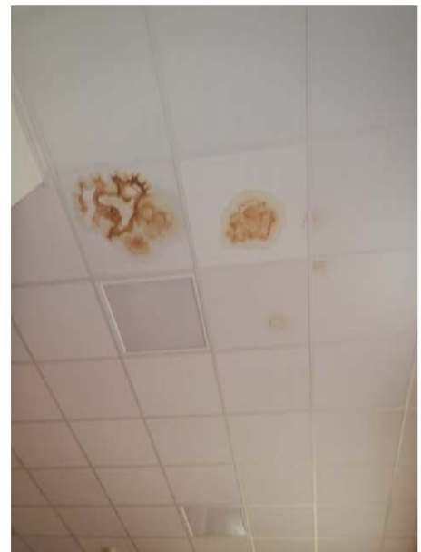
Dak [5]-vernieuwd deel: vochtsporen op plafond.
