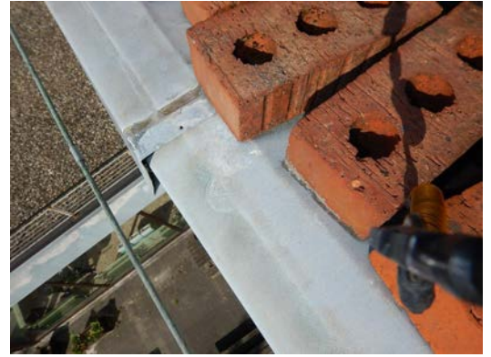
Dak [1]: dakrand wordt vastgehouden met bakstenen.
