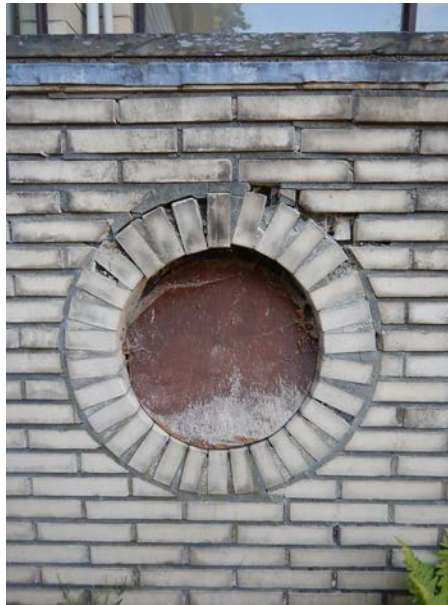
Vleugel [8]-noord: weggefallen voegwerk.
