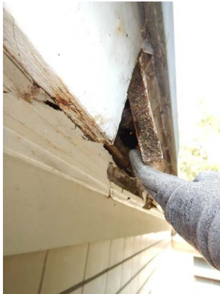
Dak [3]-oost: vervolgschade > ingerotte kroonlijst.
