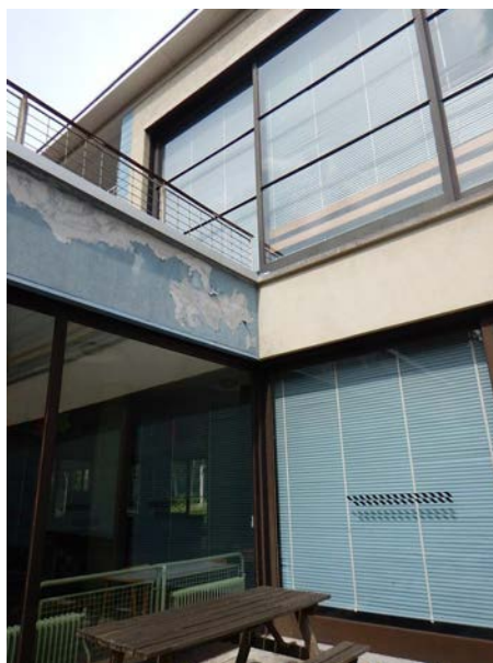
Vleugel [9]: afbladderende afwerkingslaag.
