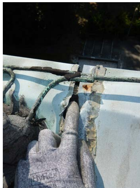
Dak [1]: gebrekkige dakrand, houtwerk ligt bloot.
