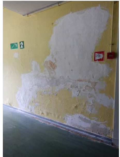
Vleugel [1]-balkon: vochtschade (situatie int.).
