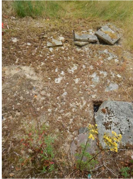
Gevaarlijk losliggende tegels.
