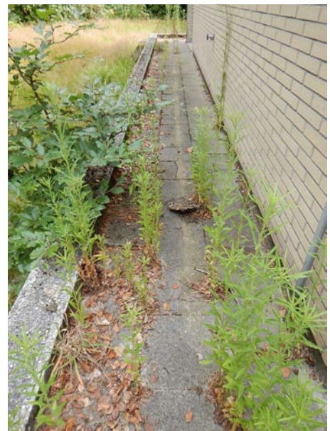
Onkruid in bestrating rond gebouw.
