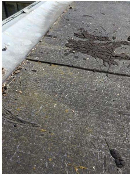
Algemeen: verweerde roofing.
