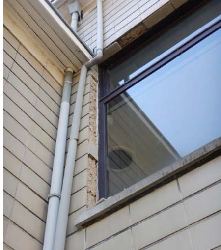
Vleugel [1]-noord: weggevallen tegels dagkant.
