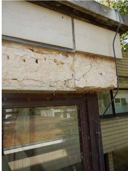
Vleugel [1]-noord: loshangende tegels verwijderd door Mowa.
