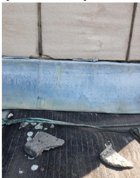
Dak [2]: weggevallen aansluiting met vleugel [1].
