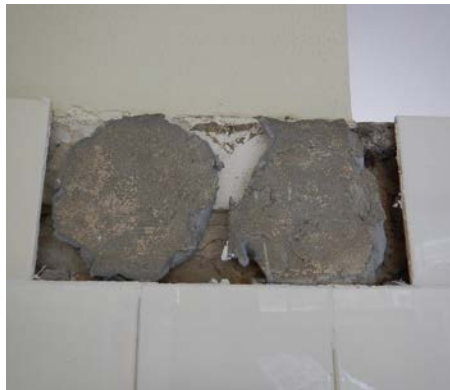
Weggevallen tegels badkamer.
