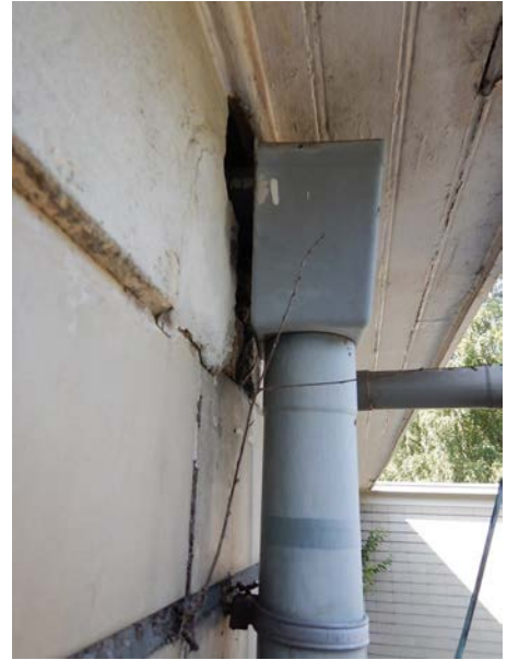
Dak [1]-noord: losgekomen vergaarbak voorlopig teruggeplaatst door Mowa.
