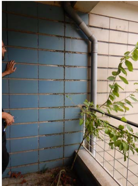
Vleugel [1]-balkon: verweerd voegwerk (situatie ext.).
