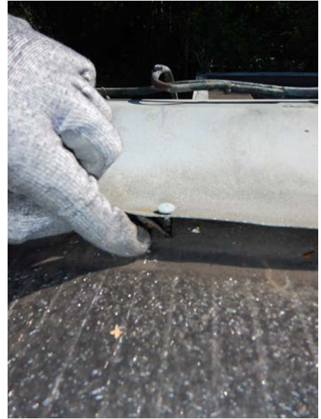
Dak [3]: dakrand vernageld in dakbedekking > kleine lekken tot gevolg.
