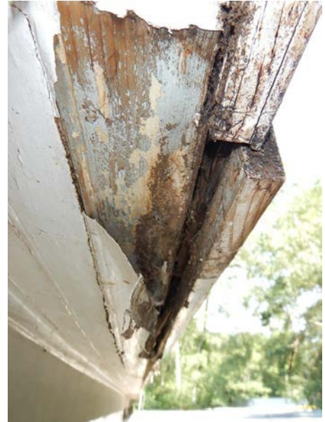
Dak [3]-oost: vervolgschade > ingerotte kroonlijst.
