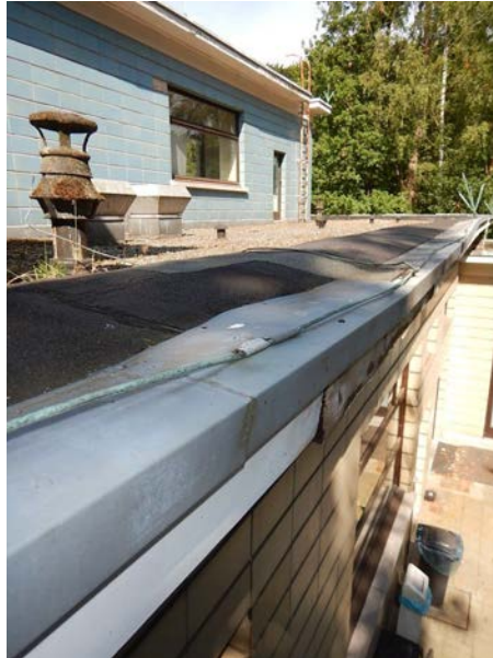
Dak [3]-oost: bochtig verloop dak, bovenkant staat bol > water kan onder dakrand.
