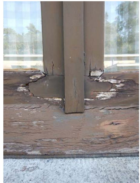
Vleugel [2]-west: ingerot - en reeds hersteld - houtwerk.
