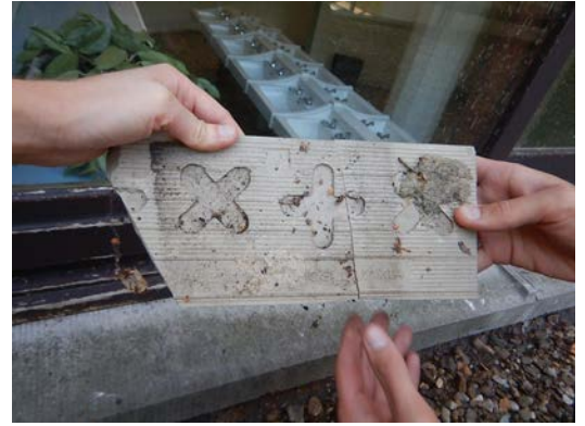
Vleugel [1]-noord: weggevallen tegels.
