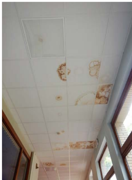
Dak [5]-vernieuwd deel: vochtsporen op plafond.
