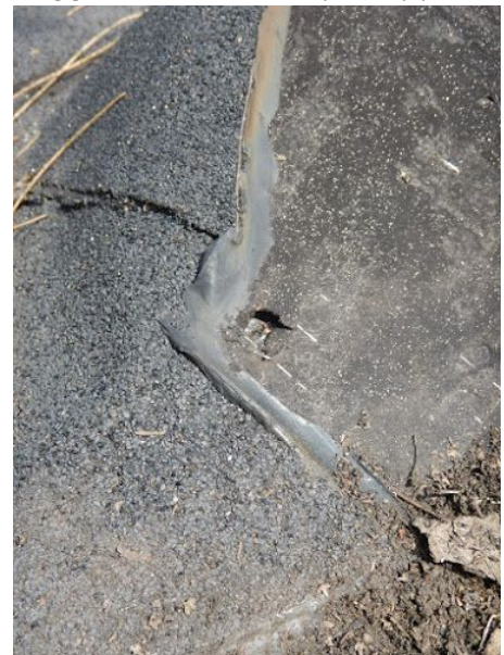
Dak [5]: lek? naast naad vernieuwde deel.
