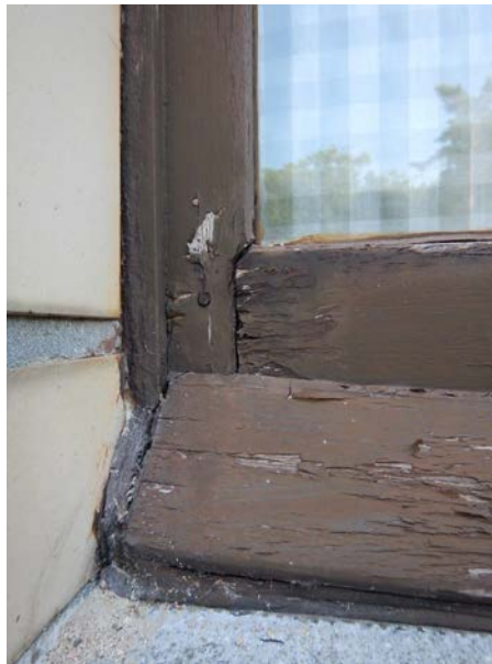
Vleugel [2]-west: ingerot houtwerk.
