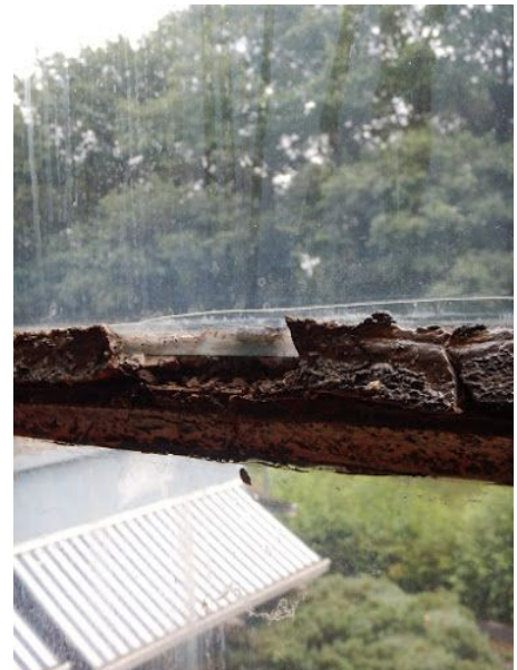
Vleugel [1]: roestig schrijnwerk.
