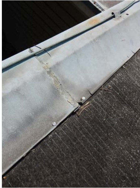
Dak [3]: dakrand vernageld in dakbedekking > kleine lekken tot gevolg.
