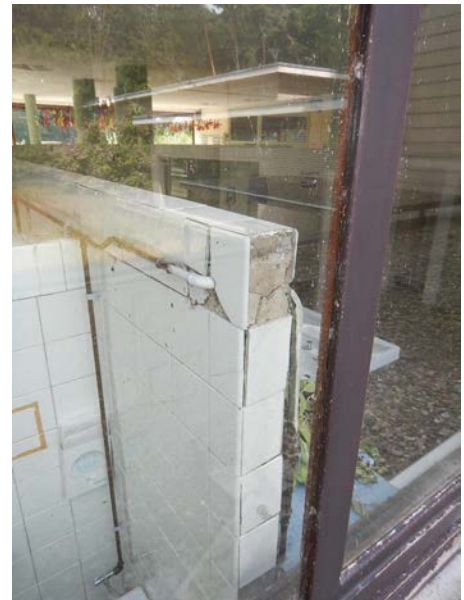
Weggevallen tegels badkamer.
