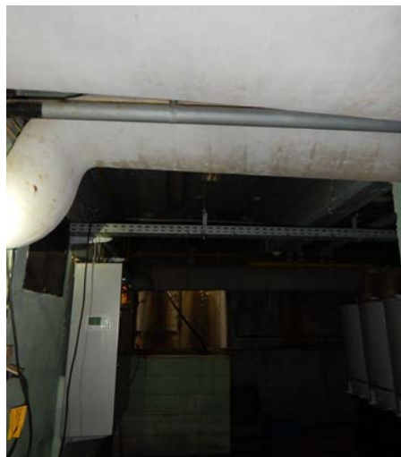
Asbesthoudende isolatie rond leidingen?
