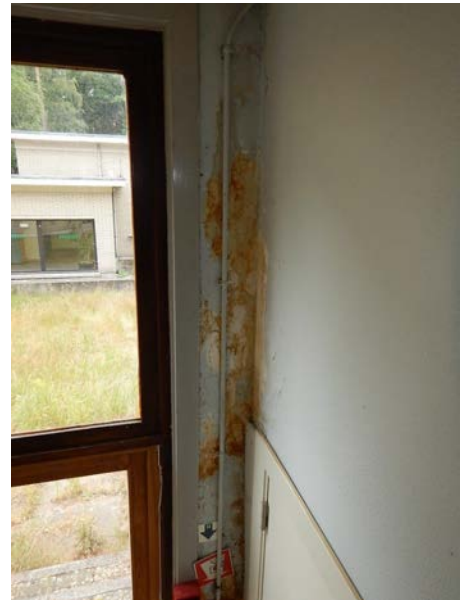
Vleugel [3]-noordwestelijke hoek: vochtdoorslag?
