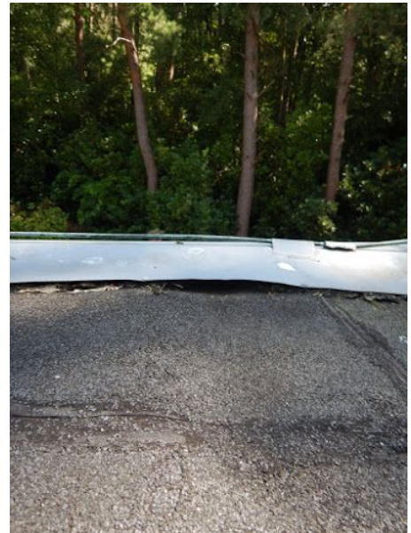
Dak [3]-oost: bochtig verloop dak, bovenkant staat bol > water kan onder dakrand.
