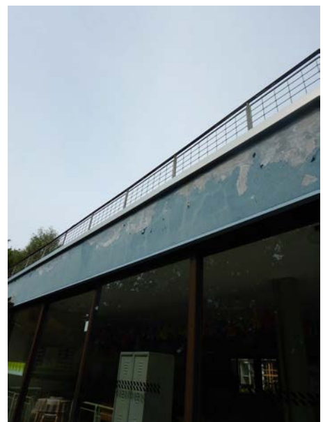
Vleugel [9]: afbladderende afwerkingslaag.
