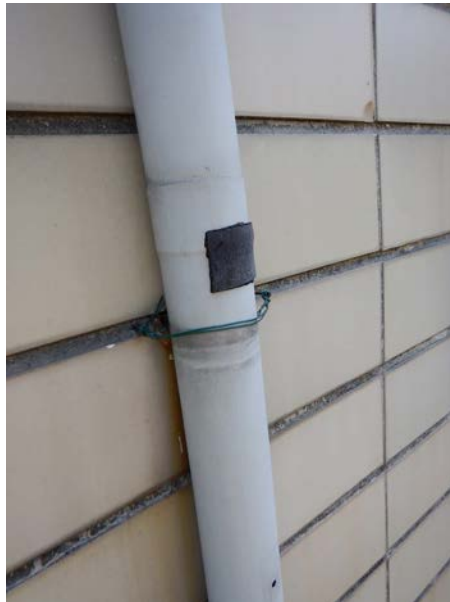
PVC-afvoer, reeds hersteld. Afvoerbeugel is weggefallen.
