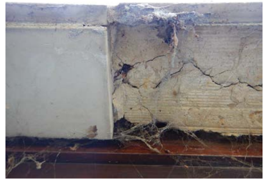
Vleugel [1]-noord: weggevallen tegels dagkant.
